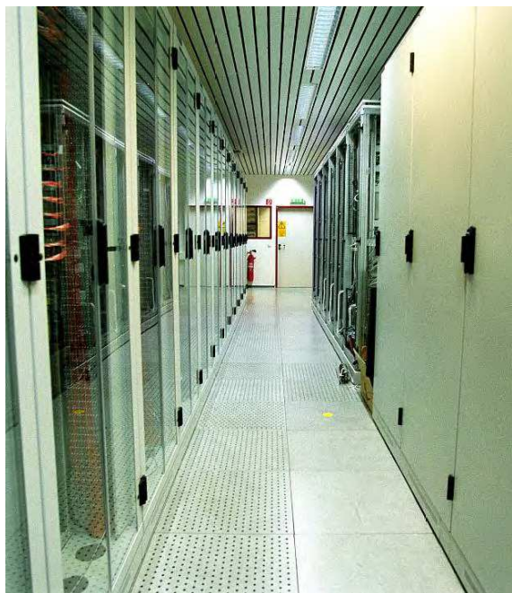
Místnost se síťovým zařízením v řídicím středisku laboratorního modulu Columbus.
