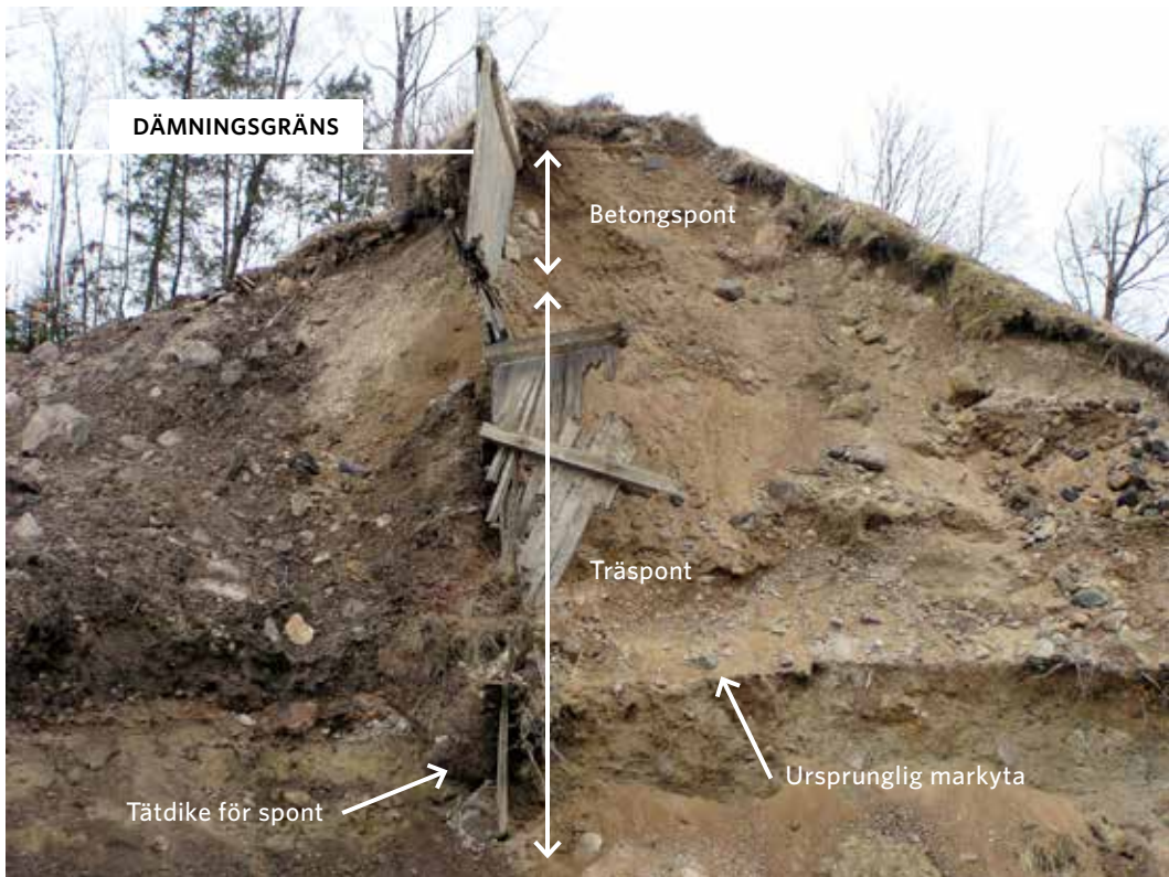
Spontrester och tvärsnitt för havererad fyllningsdamm (Hästberga). Dammen höjdes två meter efter ursprungligt färdigställande. Sponten utgörs överst av betongspont, därunder av den ursprungliga träsponten.
