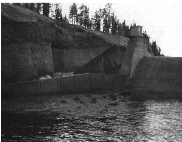
Selsfors 1943, Skellefteälven. Haveri i lamelldammen vid höger anslutning i samband med första dämningen av magasinet. Monoliterna var grundlagda på jord och haveriet orsakades troligen pga. erosion i grunden.
