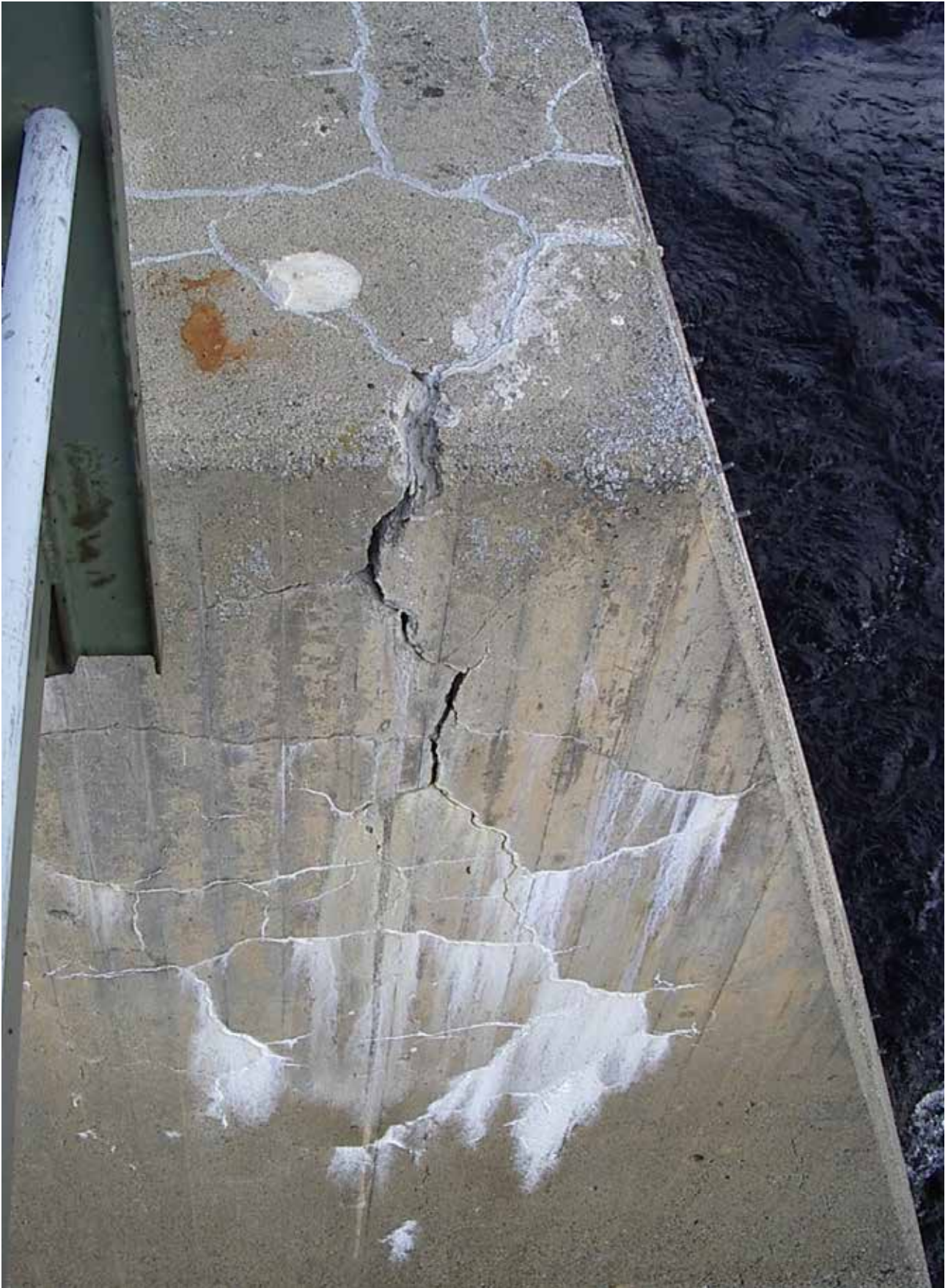
Utskovspelare skadad av Alkali-Silika-Reaktion (ASR).
