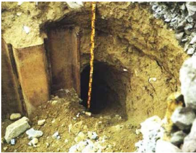
Spår av läckageproblematik vid spont, en rörformig öppen läckväg har bildats i tätkärnan.
