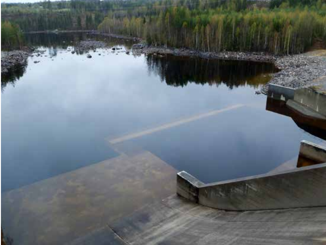
Energiomvandlare. Bassäng nedströms skibord.
