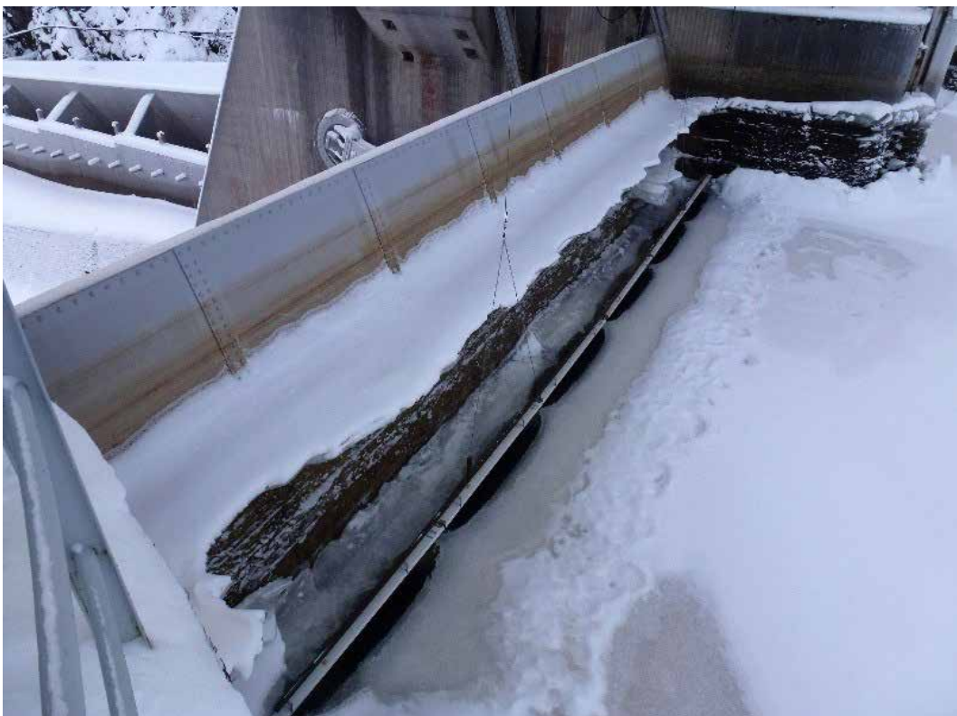
Påfrysning mot uppströmssidan av segmentlucka.
