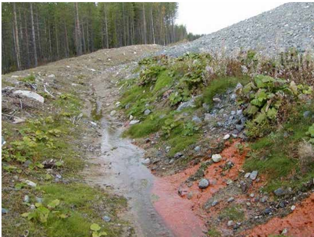
Läckage i nedströms dammtå.
