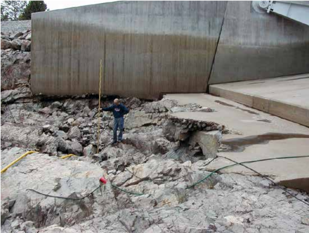
Erosion från utskovtappning.
