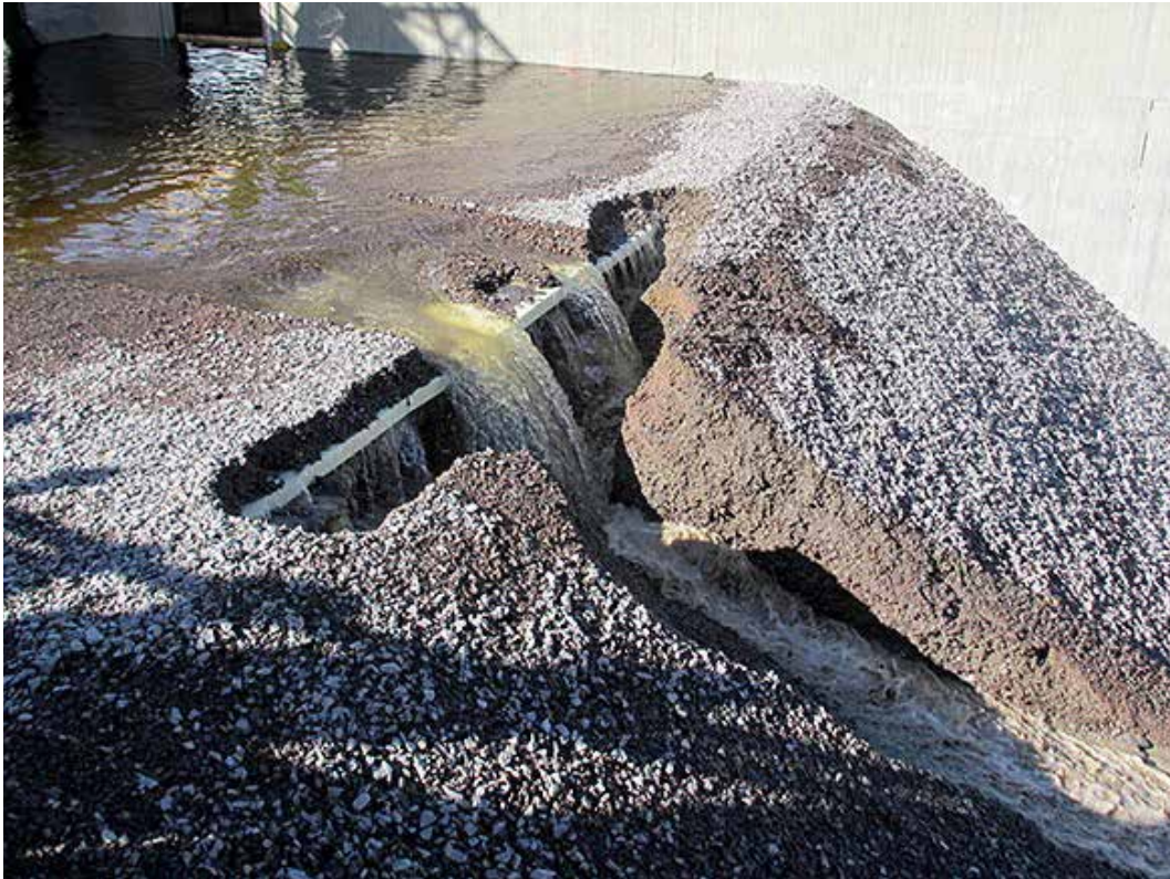
Fältförsök med överströmning av en eroderbar dammdel som byggts upp i ett utskovsparti.
