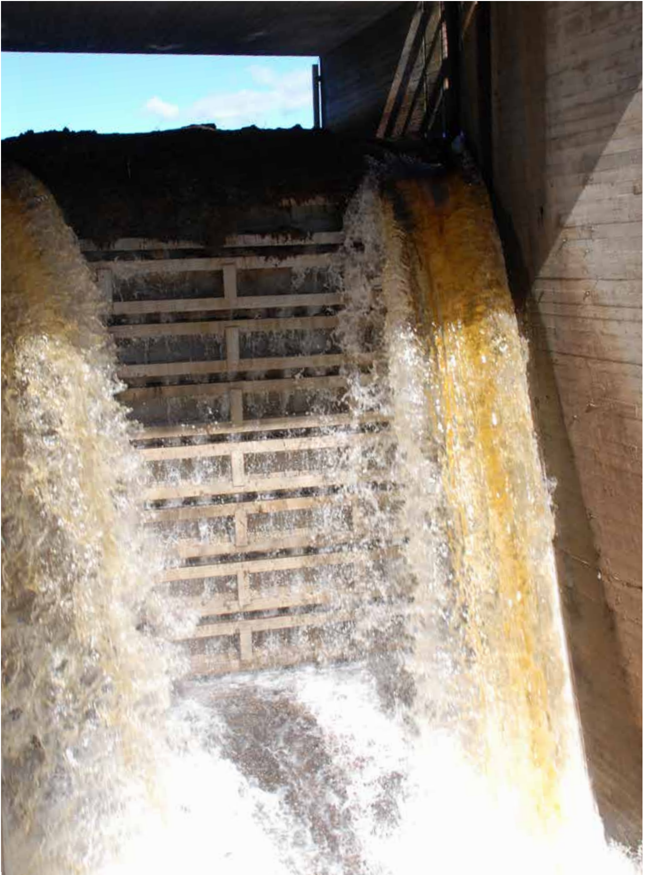
Flyttuva ligger an mot sättlucka och begränsar överströmningen.
