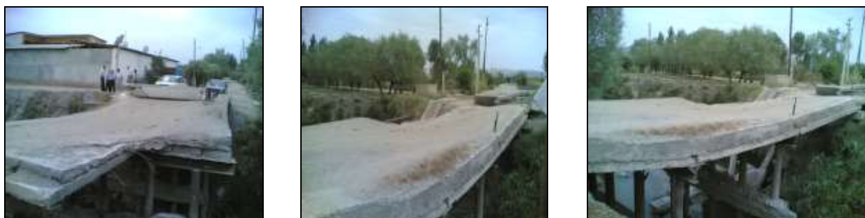
Рис. 4.7. Разрушение моста на селерусле "Ляккан-1".
