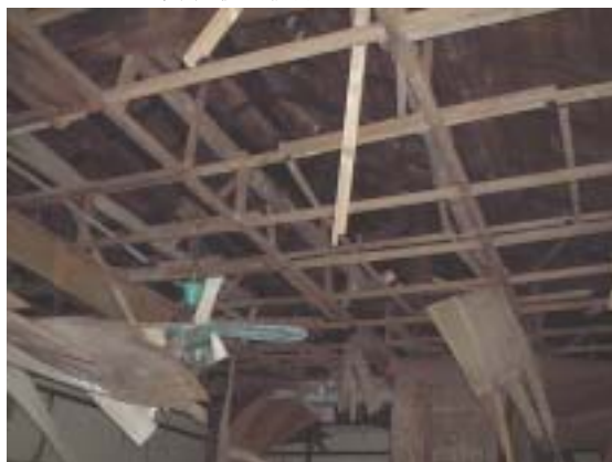
圖 2-2-24 前 13 室內天花已完全毀壞，部份屋架亦嚴重損毀。
