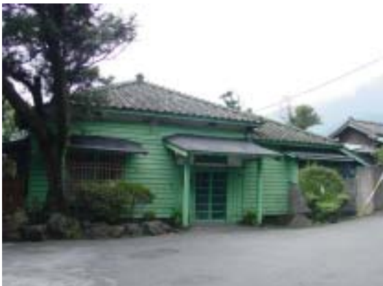
圖 2-2-46 後 2 正面入口，為一樓木造斜屋頂建築，黑色瓦片、雨淋板外牆。
