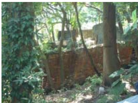
圖 2-2-54 後 6 已嚴重損壞之其中一棟建築，目前僅剩磚牆。
