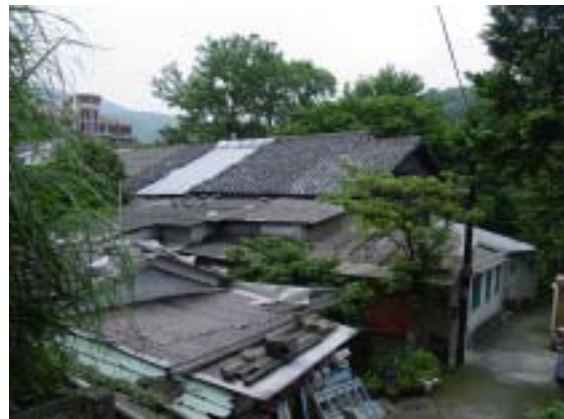
圖 2-2-32 前 17 出租旅館舊址，舊有建築大都已破舊且修建情形嚴重。
