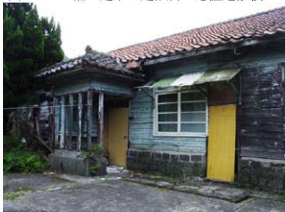
圖 2-2-44 補 1 建築已建傾斜，應儘速修復。
