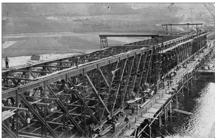
Stavba nového dvojkolejného mostu železničního přes řeku Berounku mezi Dolními a Horními Mokropsy archiv Všenorské knihovny
