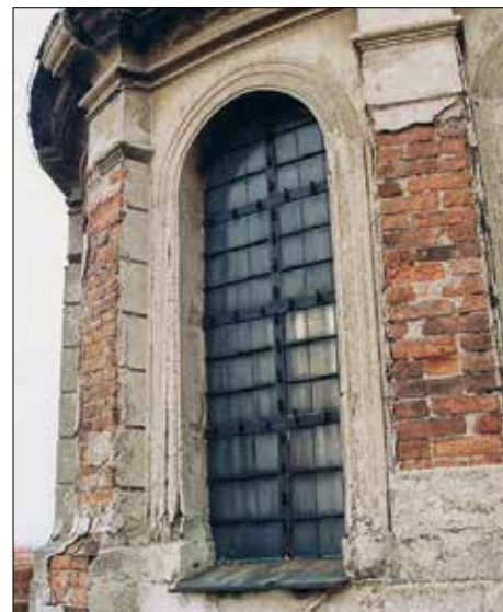
Stav kaple sv. Klimenta před opravou.
