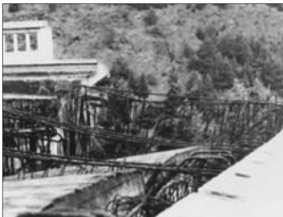
Pokles skruže a výztuže nedokončeného krajního (jihlavského) pole mostu přes údolí Želivky u Píště (foto v roce 1958).
