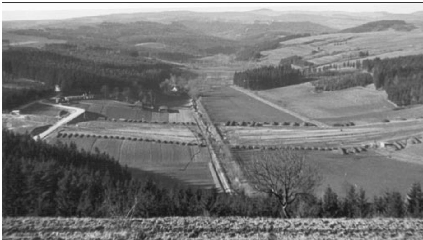
Pohled do údolí říčky Býkovky na jaře 1940: Za stavenišťem dálnice je dělnický pracovní tábor Postdam, ve kterém byli ubytováni dělníci firmy Hrabě & Lozovský.
