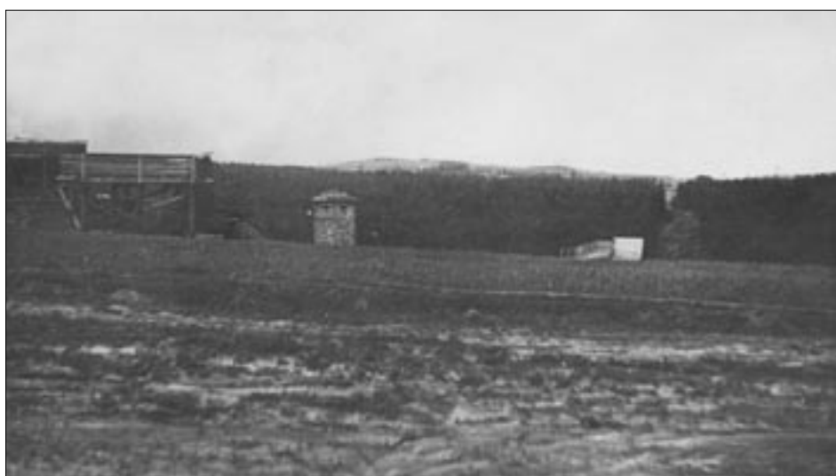
Staveniště mostu přes údolí Hlubockého potoka, v pozadí konstrukce kabelového jeřábu na severní straně údolí říčky Lubě
