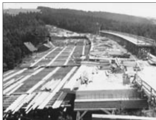
Stavba mostu přes údolí Želivky (stavební díl 12/1) firmou Ing. Brázdil a Dr. Ješ v roce 1948 (bednění mostovky levého mostu).
