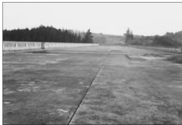
Nedokončená izolace Pragobit na obou mostovkách pražské strany mostu přes údolí potoka Šmejalky u Senohrab.
