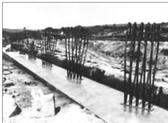
Stavba mostu přes údolí Božkovského (Zlatého) potoka u Kunic (stavební díl 6/2) v srpnu 1940 (kotvení výztuže kvyňých stojek).
