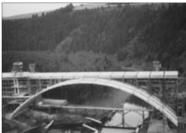
Rozestavěný most přes údolí Želivky (stavební díl 12/1) v roce 1943. Odkružení oblouků levého mostu bylo nakonec povoleno.
