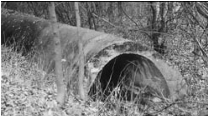
Nedokončený propustek v Karlově pod Ještědem.
