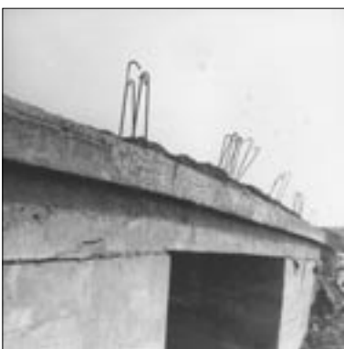
6 – detail římsy s trhlinou nad nepokleslým pilířem
