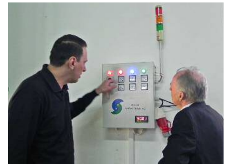
Ivan Poljanica zeigt dem Redaktor an der Schalttafel am Ausgang des Generators die elektrischen Leistungen, die von den Verbrauchern (7-kW-Boiler-Heizstäbe und 18 Lampen mit zusammen 5 kW) konsumiert werden.
