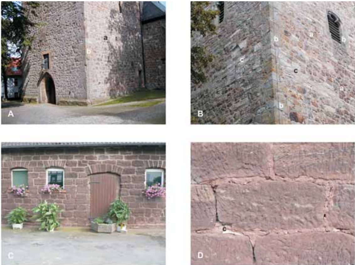
Abb. 24: Gault-Sandstein. A-B Lichtenau, kath. Pfarrkirche St. Kilian, frühes 14. Jh., Turm-Südwestecke, A Untergeschoss, B Wandausschnitt, C-D Herbram, Ackerbürgerhaus Iggenhausener Straße 3, erbaut 1911, C Anbau Nordseite, D Detailsicht. a Gault-Sandstein, b Osning-Sandstein des Eggegebirges, c Plänerkalksteine der Baddeckenstedt-Formation, Wambel-Member.
