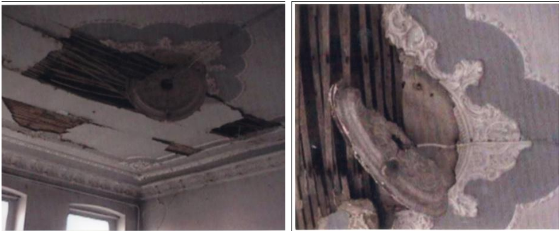
Şekil 5.3 : Yapının döşemelerinde meydana gelen çökme ve tahribatlar (Y.M.A arşivi).
