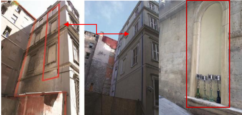
Şekil 5.24 : Saka Salim Çıkmazı Cephesi, doldurma ve boşaltmalar (Fotoğraflar:Dinç, 2012 ve Kişisel arşiv).
