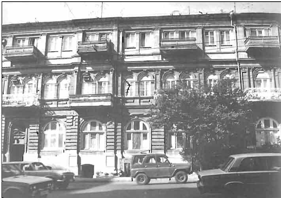
Kaspiyskaya küçəsi, 25. Murtuza Muxtarovun yaşayış evi. Şərqi fasadının ümumi görünüşü. Mülki mühəndis İ.K. Ploşko. 1910-cu il.
