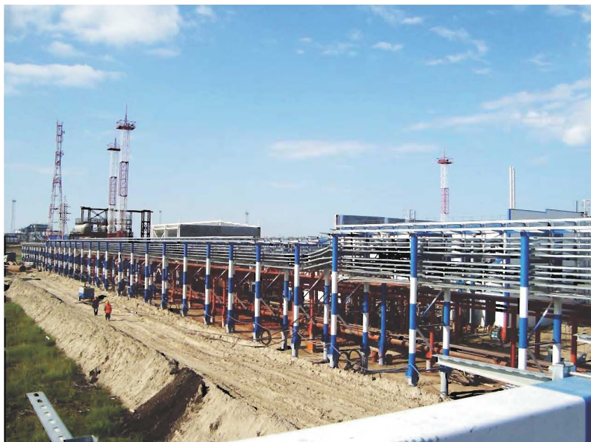
Qaz-turbin elektrik stansiyası
