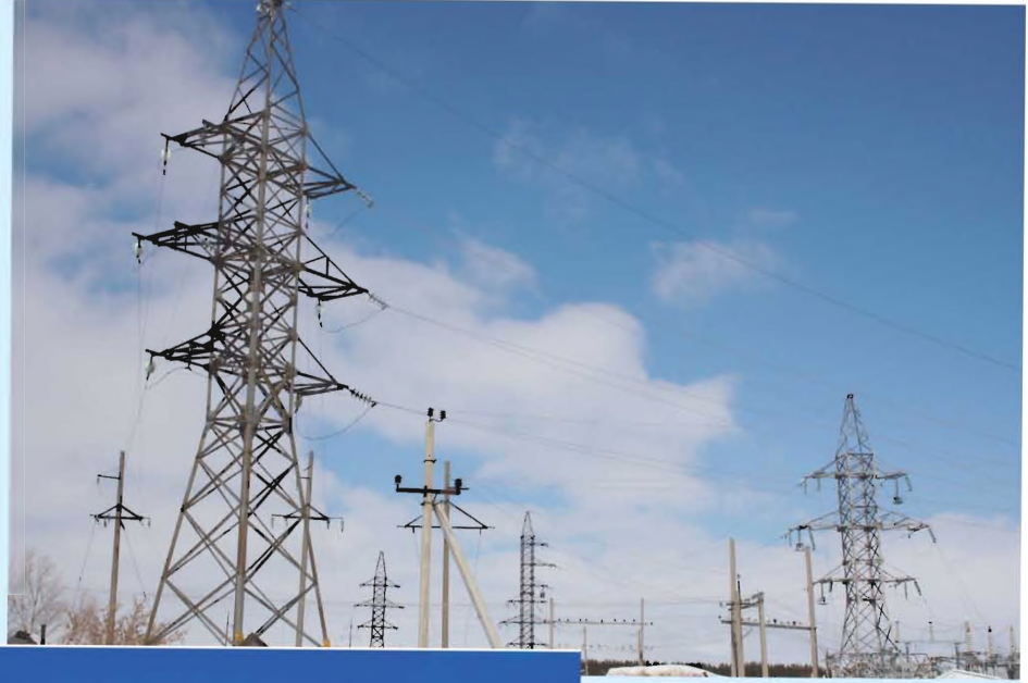
Yüksəkgərginlikli elektrik xətləri
