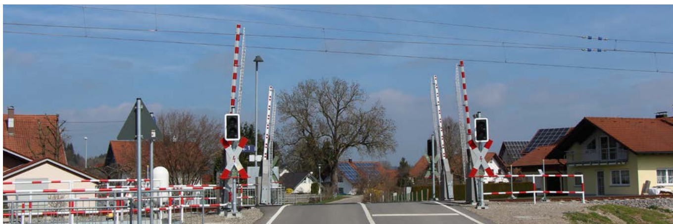
Zahlreiche Bahnübergangssicherungsanlagen wurden für die neuen Geschwindigkeiten ertüchtigt. Diese Anlage in Aichstetten erhielt einen Vollschrankenabschluss und eine Gefahrraumfreimeldeanlage.
