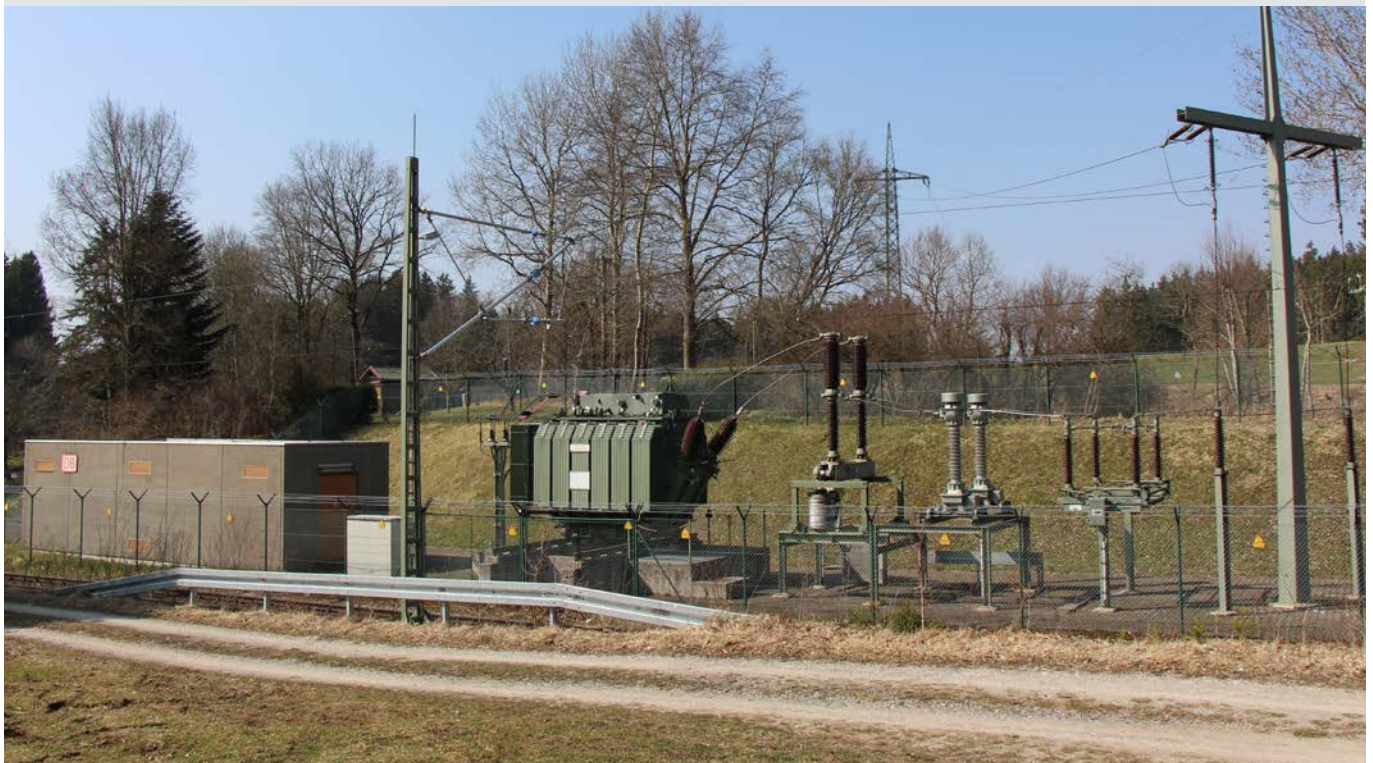
Das Unterwerk in Geltendorf wandelt den Bahnstrom mit 110-Kilovolt in Strom für die Oberleitungen mit 15-Kilovolt Spannung um.
