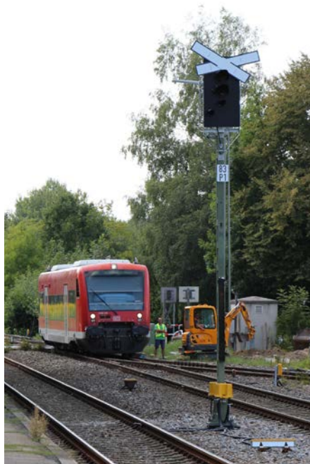
Die 57 Jahre alte Signaltechnik in Kißlegg wird durch ein neues elektronisches Stellwerk ersetzt.
