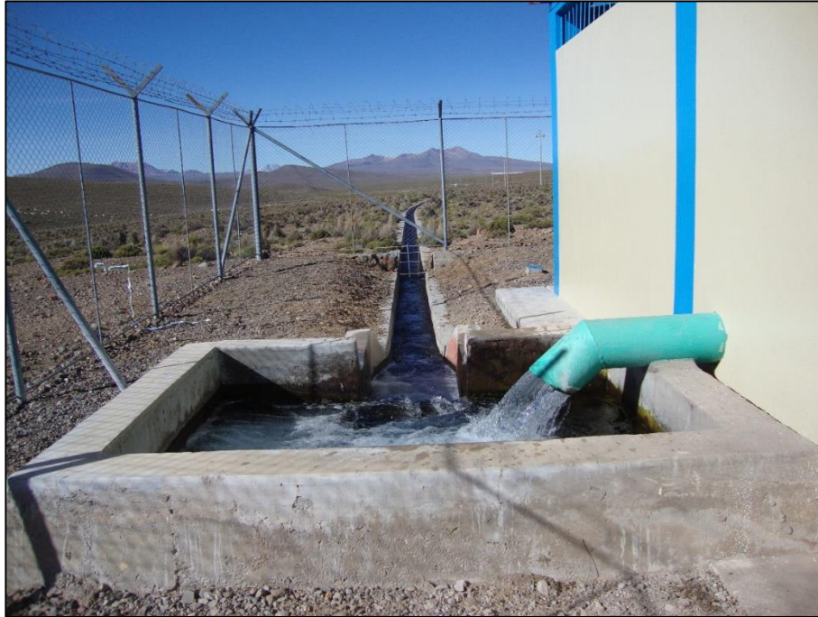
Figura No. 2-27 Fotografía del Pozo PA-13
