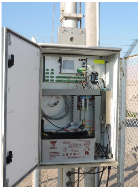
Figura No. 4-2 Panel de control de la estación automática
