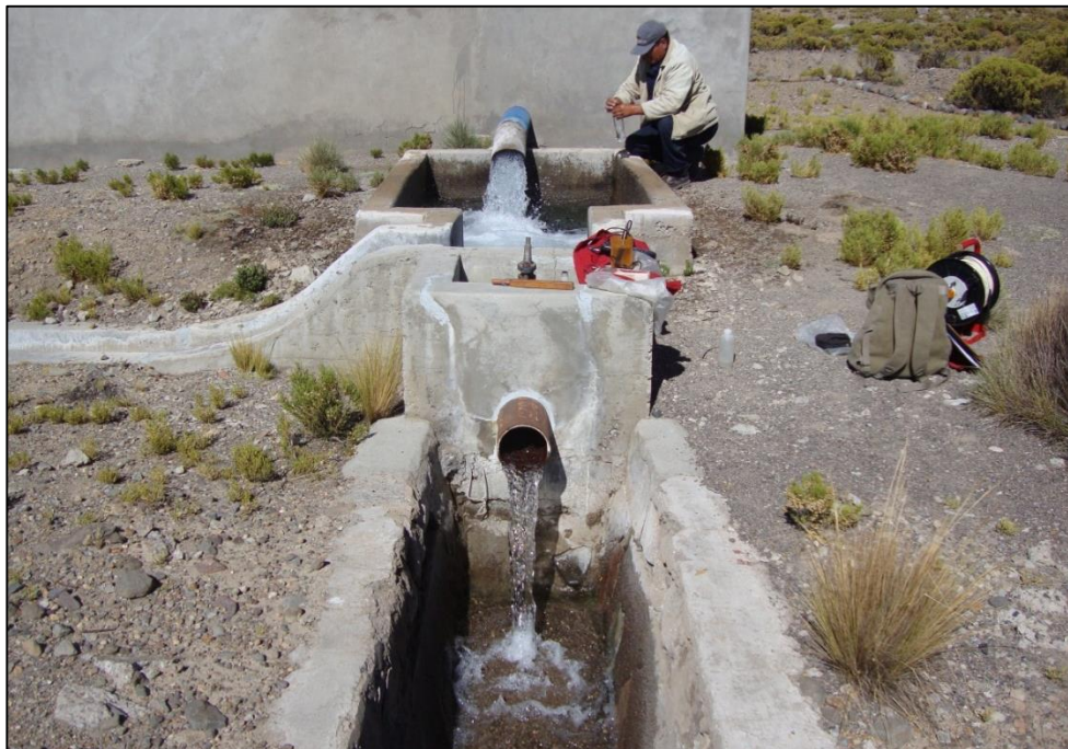
Figura No. 2-29 Fotografía del Pozo PA-9
