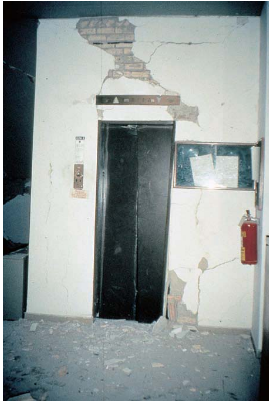
Εικ. 3.16. (αριστερά) Αίγιο, σεισμός 1995. Ο ανελκυστήρας είχε πάθει βλάβες. Η χρήση του την άμεση μετασεισμική περίοδο μπορούσε να προκαλέσει τον εγκλωβισμό ατόμων.
