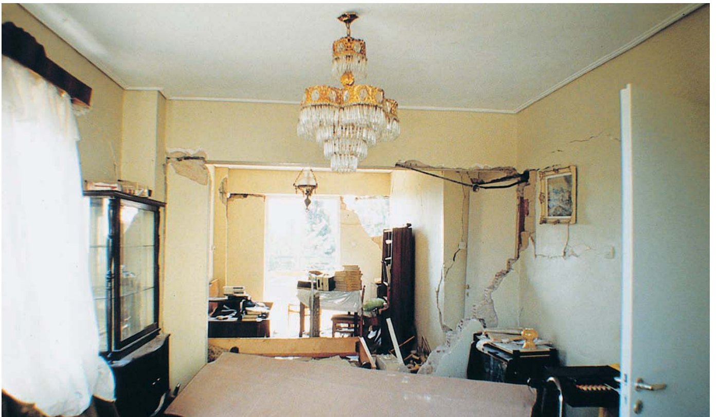
Εικ. 3.12, 3.13. Καλαμάτα, σεισμός 1986. Στα διαμερίσματα αυτά δεν είχε γίνει προσεισμικά άρση επικινδυνότητας και πρόβλεψη για κατάλληλη στήριξη των επίπλων με μεταλλικά ελάσματα στους τοίχους.
