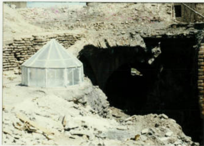
۹- قسمتهای شمالی بام - که در حال تخریب می باشد
