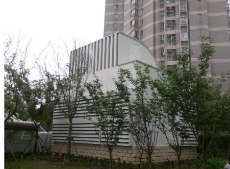
全封闭式冷却塔隔声罩
