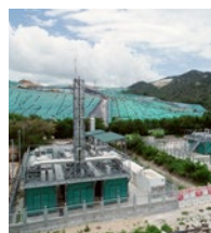
新界西堆填區 堆填沼氣發電項目
