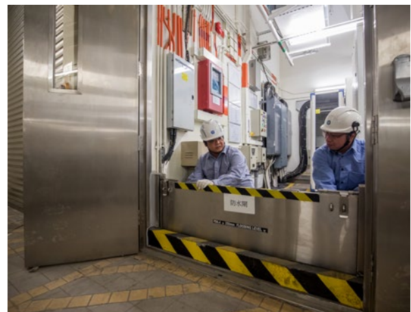
中電為受水浸威脅的輸電站及配電站加裝防水閘。
