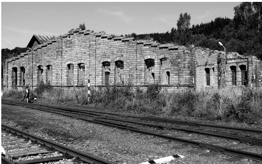
Rotunda v Kořenově čtvrt století po prolomení střechy (srpen 2010)
