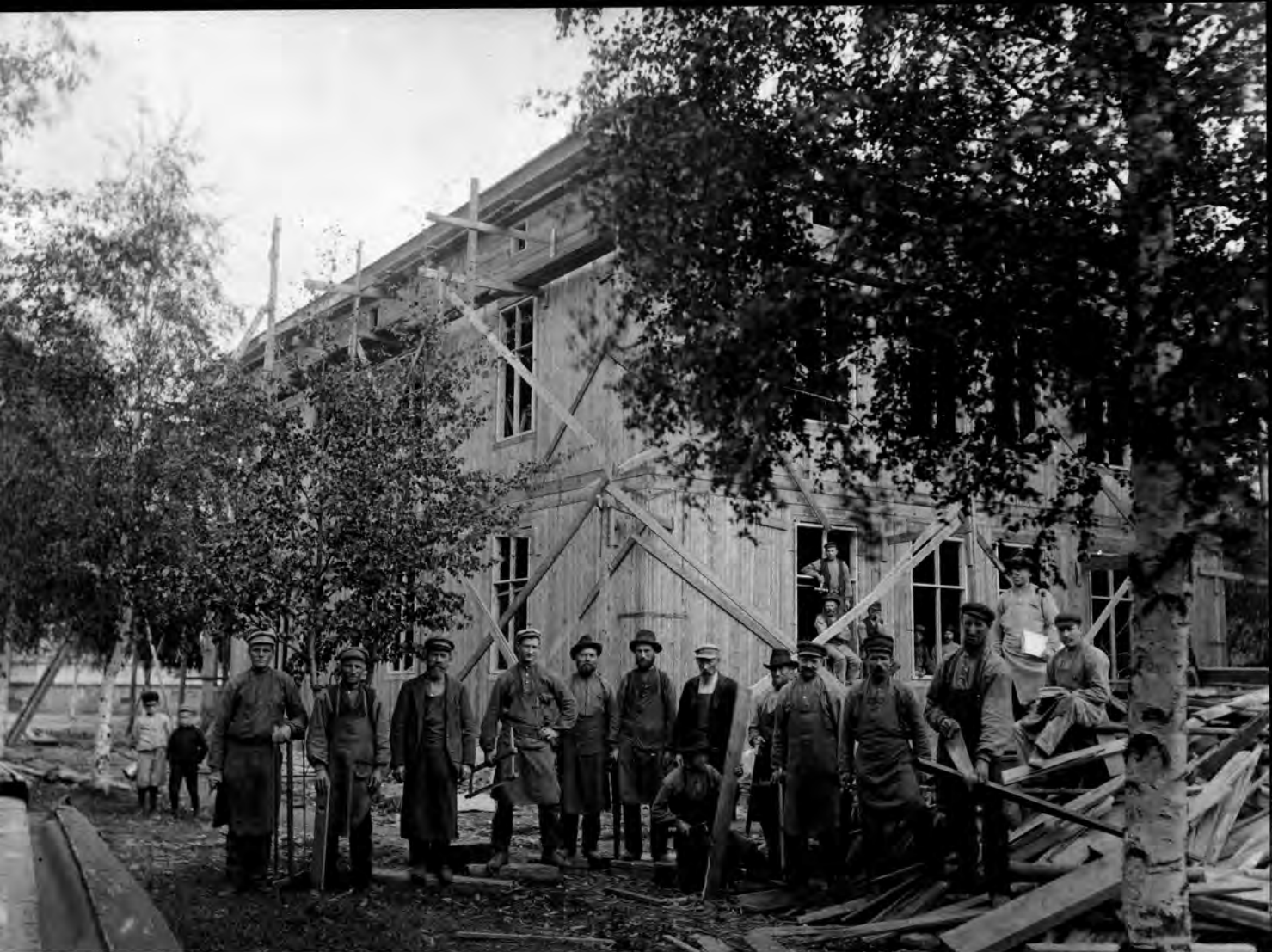
Ett byggarbetslag i Umeå cirka 1905. Hantverkarna står uppställda för fotografering och, som på så många liknande bilder, har var och en ett verktyg i handen som för att bekräfta sin identitet. Bilden är tagen vid bygget av köpman A Lundströms fastighet, ett bostadshus med butikslokaler i bottenvåningen i hörnet Kungsgatan/Västra Esplanaden. Det är ritat av en av stadens kända arkitekter vid denna tid, sparbankskammern Erik Olof Mångberg, som till exempel också ritat Tullkammaren vid älven. Fastigheten vid Västra Esplanaden finns fortfarande kvar och inrymmer bland annat ett antikvariat idag. Okänd fotograf.
