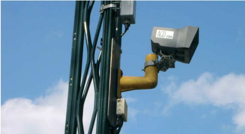
Figur 2-68: Radar plassert på gittermast.
