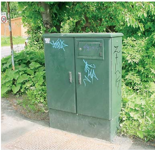
Figur 4-9: Tagging på styreskap bør fjernes.
