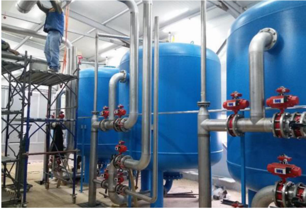
Filter postrojenje Karašnica
