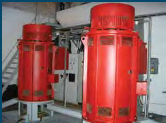
Vertikalieji hidrogeneratoriai Vertical hydrogenerators
