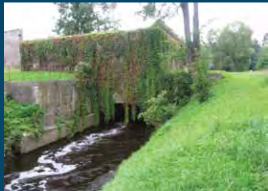
HE ištekėjimo dalis Water outlet structure
