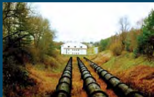
Gelžbetoniniai slėginiai vamzdžiai Concrete penstocks
