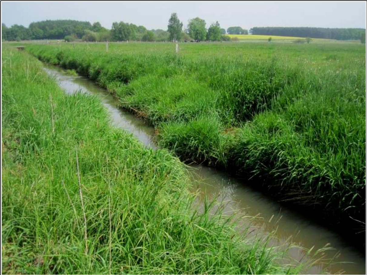
Foto 17 - Delme - Oberlauf/WK 23025 - unterhalb der K54/Kl. Köhren: Instabile Gewässerböschung/Uferabrutschung
