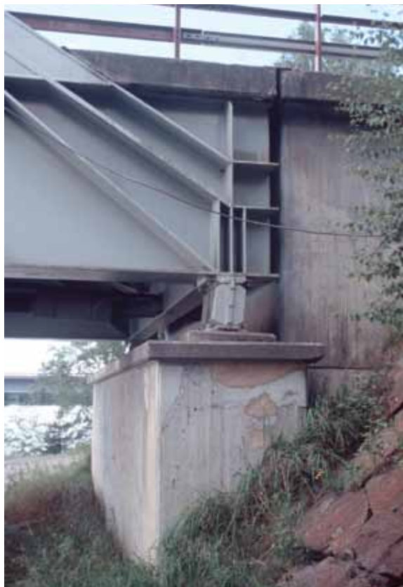
Upplaget på norra sidan av bron visar hur kraftiga förstärkningsflänsar har svetsats på huvudbalkarnas utsidor vid mötet mellan båge och balk. Ett vipplager per balk tar upp eventuella längdförändringar hos bron. Foto: Kulturbyggnadsbyrån, Sven Olof Ahlberg
