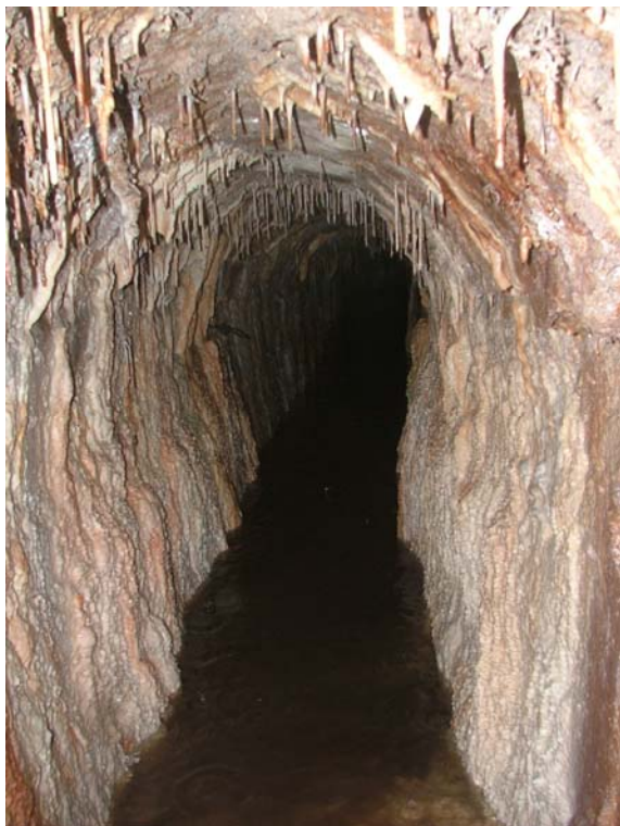
Figura 4. Cunicolo parzialmente allagato (prima dei lavori di ripristino).
