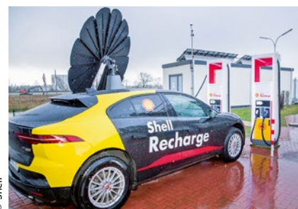
Ein besonderes Augenmerk legt Shell im Rahmen der CO 2 -Vermeidung auf die Installation von Elektroladesäulen.
