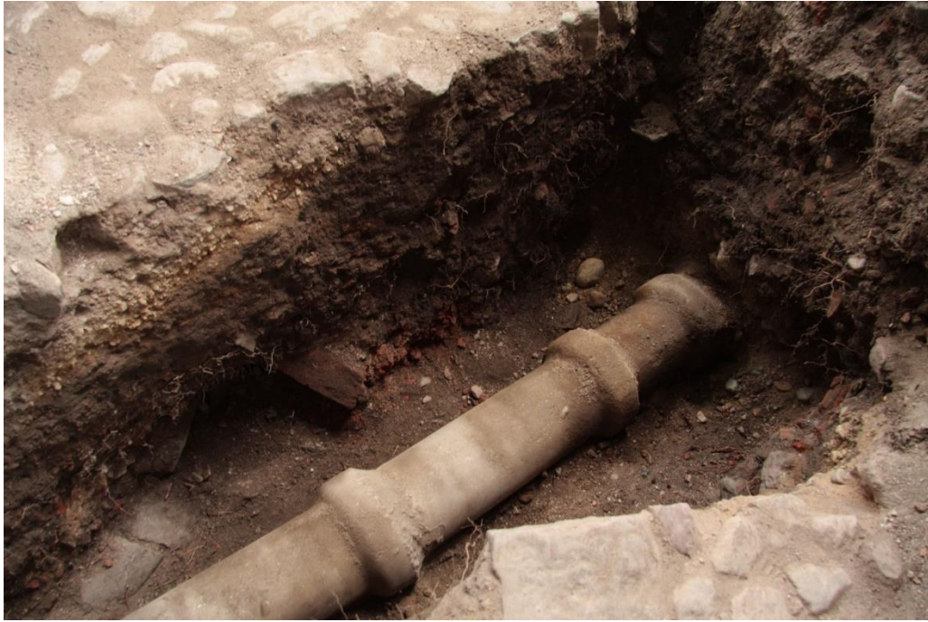
Kuva 38. Kiveyksen R101 alapuolinen pohjustushiekka M112 ja sen alla oleva tumma, orgaaninen M113 etelään. Kuvan keskellä kulkee betoninen viemäriputki R004/R102. Kuva AVAN2:1:215. Ilari Aalto/Aboa Vetus & Ars Nova.
