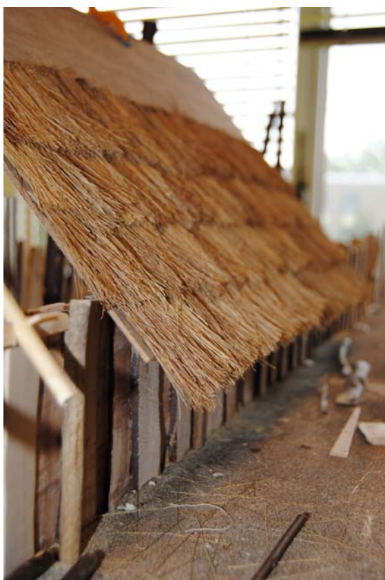
Afb. 15.17 Proef van een eerste dak, dat Matser 'te springerig' vond. Riet ligt veel strakker.
