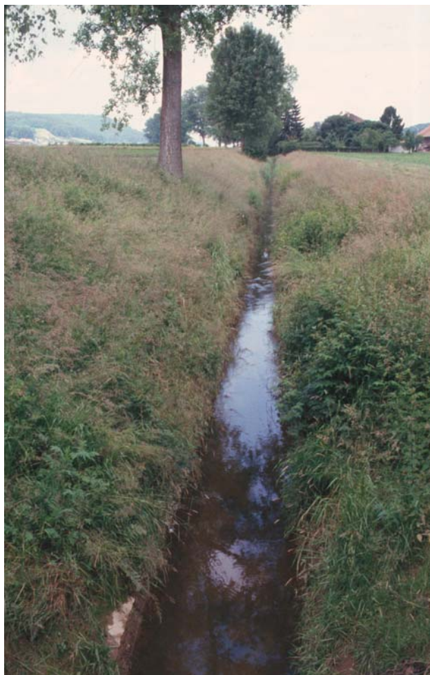
Der Oberlauf der Urtenen (Moospinte bis Kleiner Moossee) verläuft schnurgerade und hat nur vereinzelte Bäume. Die Betonhalbschalen-Sohle soll das Auflanden der Sohle und die Ausschwemmung der steilen Böschungen verhindern und einen einfachen Unterhalt gewährleisten.
