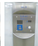
非常用インターホン
