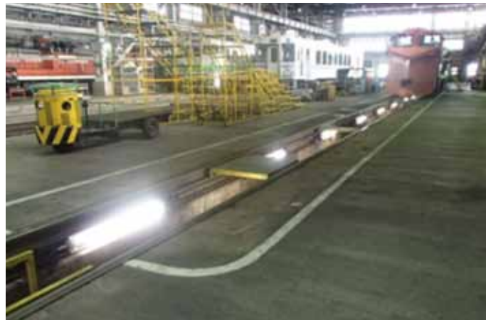
旭川運転所検修棟LED化
