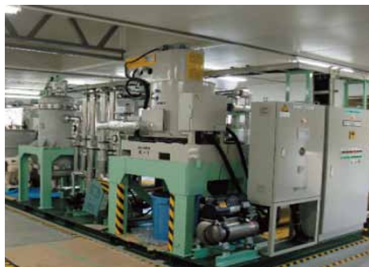
ワックス剥離廃液処理装置
