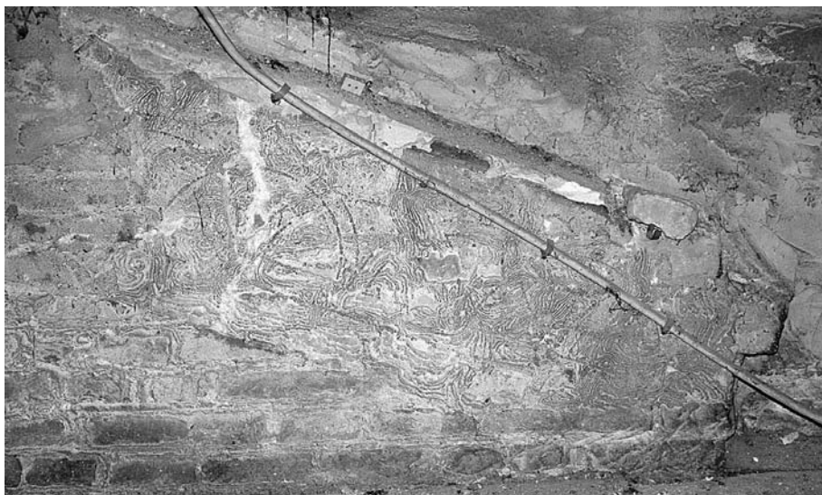
Fig. 10 – Fastigio di un edificio medievale inglobato nel teatro cinquecentesco. La linea obliqua corrisponde a uno spiovente, sotto il quale è ancora visibile un motivo ornamentale ad archetti intrecciati.
