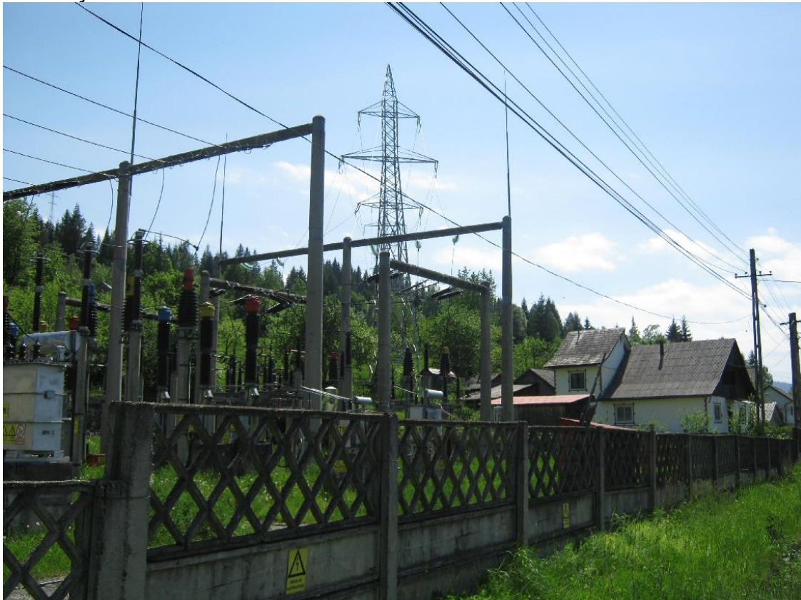
Figura 37 Stație de transformare Poiana Largului
