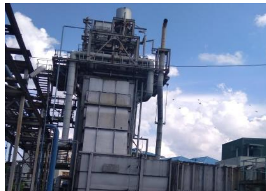
23.4 MW Hitachi CCGT
