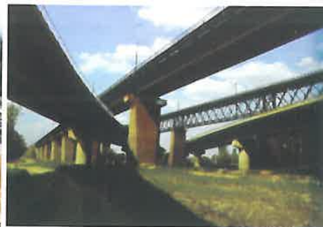
Fig. 16. A2 (Fetești - Cernavodă), km 15 + 714, viaductele de acces la podul mixt peste Dunăre, la Cernavodă
