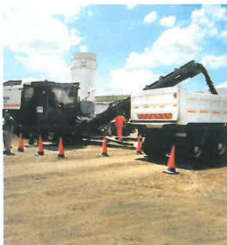
Stația de malaxare la rece produce mixtură cu materiale recuperate
