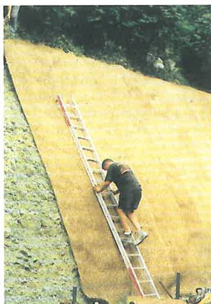
Instalarea tipului 5D de ROCKMAT pe un taluz abrupt de 65°. Taluzul a fost însămânțat înainte de instalarea GREENFIX ROCKMAT
