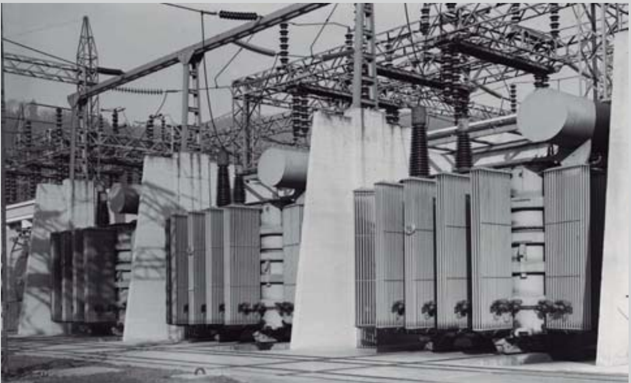
104 220/38 Kv transformadore monofasikoak Transformadores monofásicos 220/38 Kv
