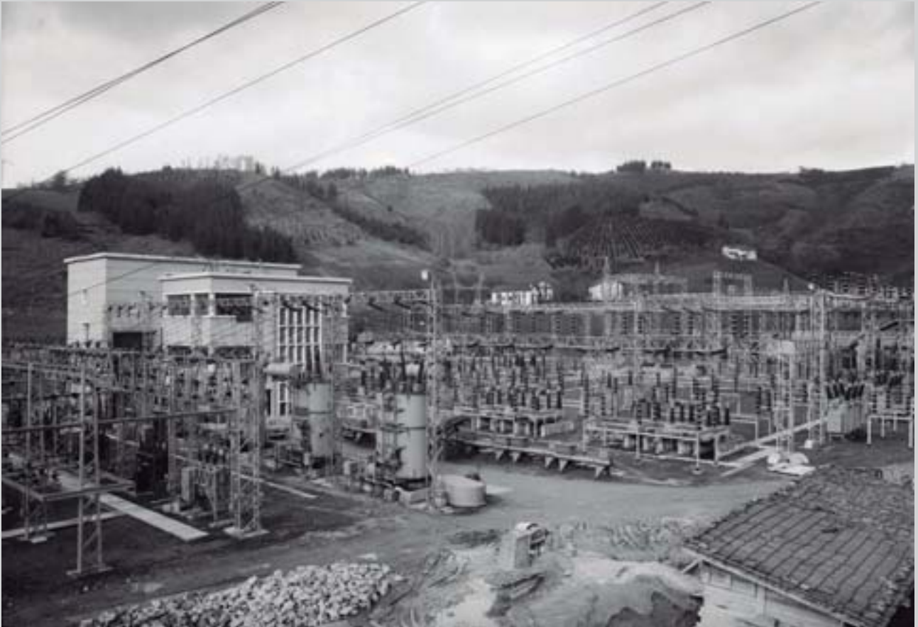
103 30 Kv-ko parkea, 138/30 Kv-ko transformadorea eta 138 Kv-ko parkea Parque de 30 Kv, transformador 138/30 Kv y parque de 138 Kv
