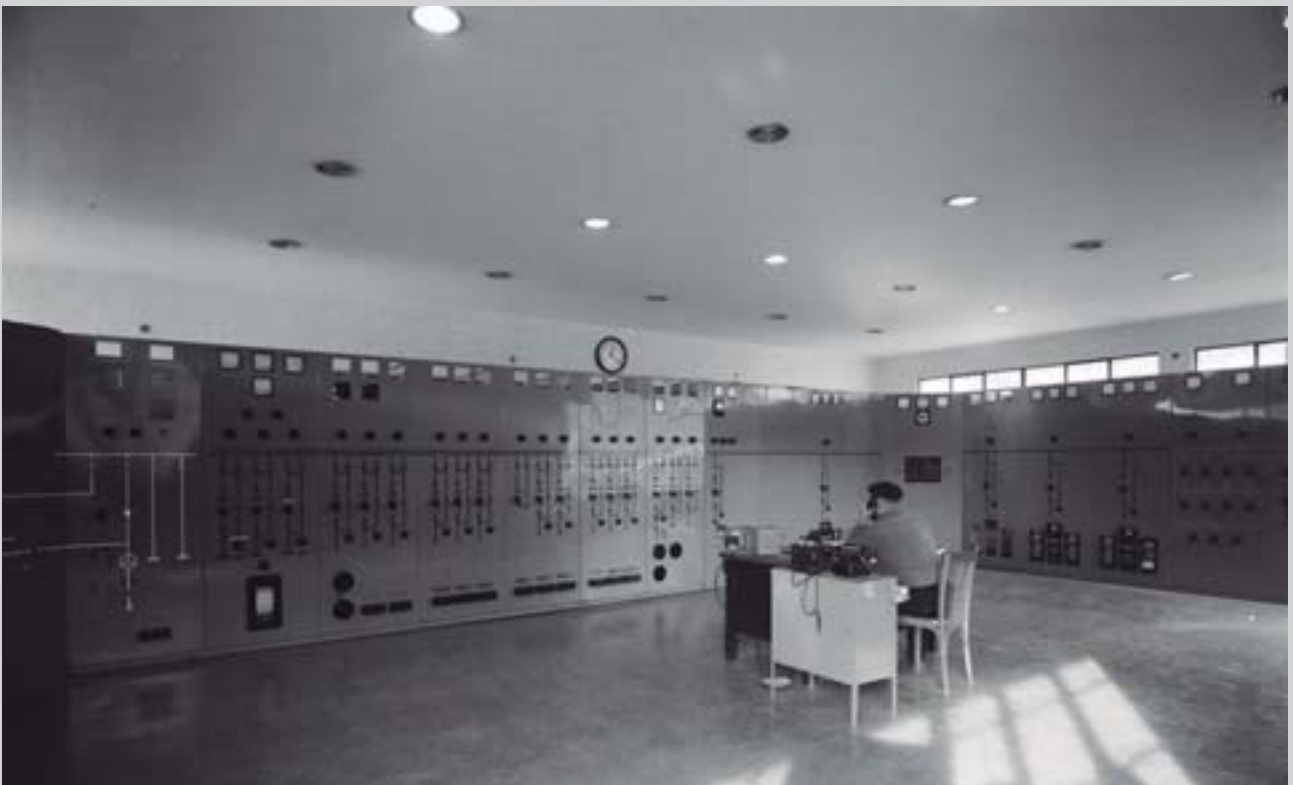
106 Kontrol-gela Sala de control
