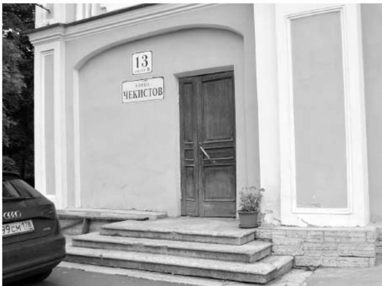
Фото 08. ОКН федерального значения «Главный дом», входящего в состав ОКН федерального значения «Дача Воронцова «Новознаменка». Южный фасад. Фрагмент. Крыльцо. Съёмка 10.09.2019 г.
