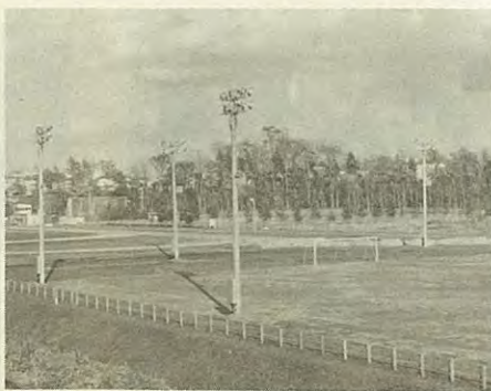
ソフトボール場に設置された夜間照明
