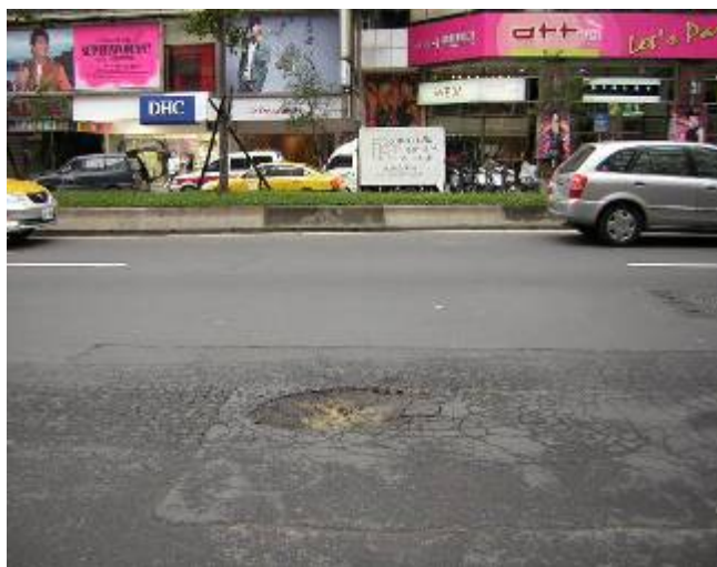
忠孝東路四段明耀百貨前發現缺失坑洞
