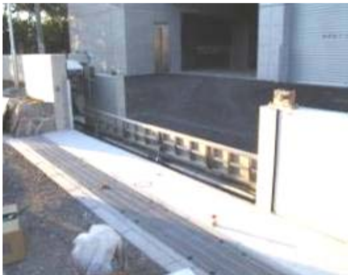
建築物出入口自動啟閉防洪閘門
