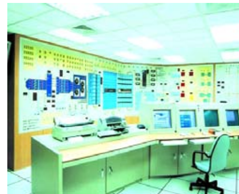
內湖污水處理廠中控室
