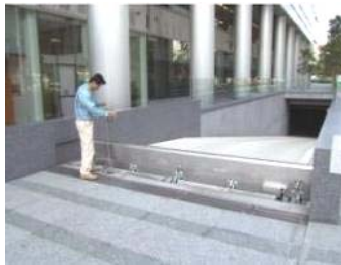
車道自動啟閉防洪閘門
