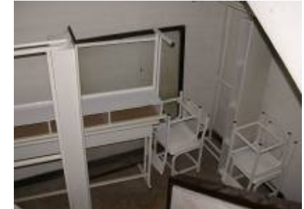
違規事項-安全梯堆 積雜物阻礙逃生
