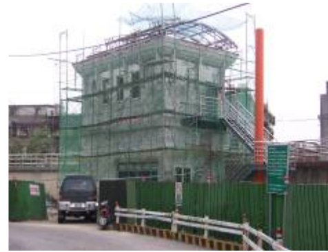
四分溪左岸抽水站工程
