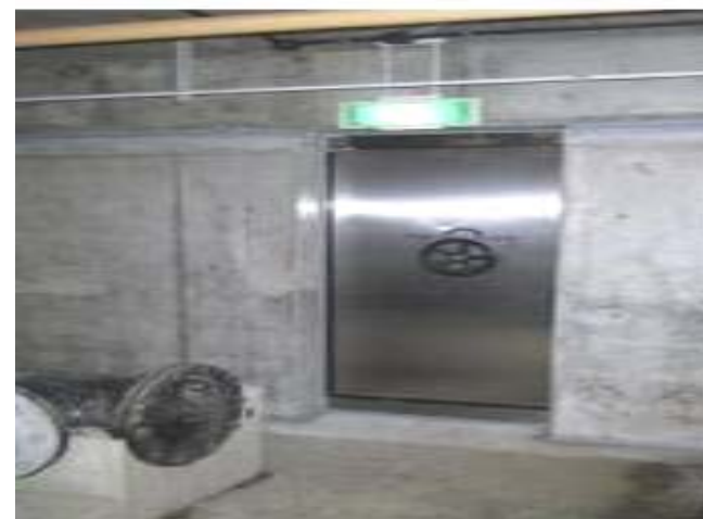
建築物出入口外牆面防洪閘門
