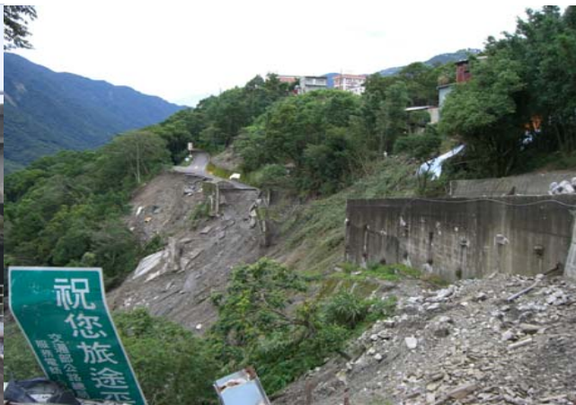
95.06.12 南投縣仁愛鄉道路崩塌
