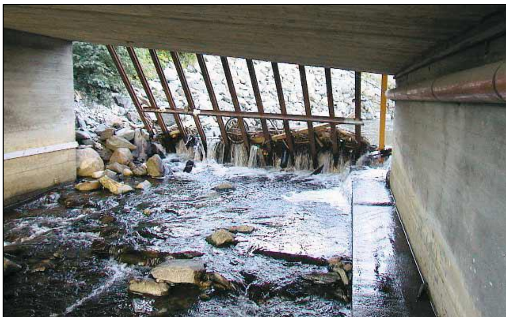
Figur 2-6 Innløp med rist som skaper et vandringshinder (DN, 2002)
