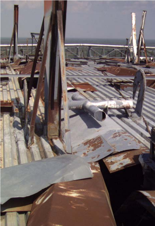
РИС. 7.2. Отверстие в крыше Укрытия, через которое проникают атмосферные дождевые осадки.
