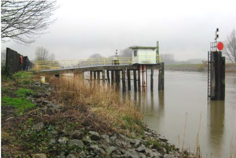
Figuur 19 - Tijmeetinstallatie te Schoonaarde op de Boven Zeeschelde.
