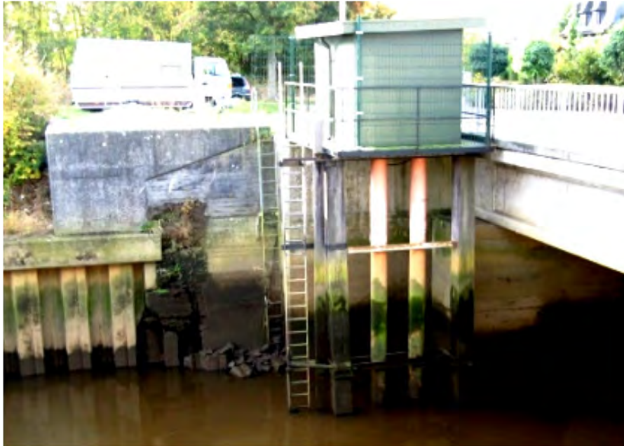
Figuur 31 - Tijdmeetinstallatie te Lier Maasfort op de Grote Nete
