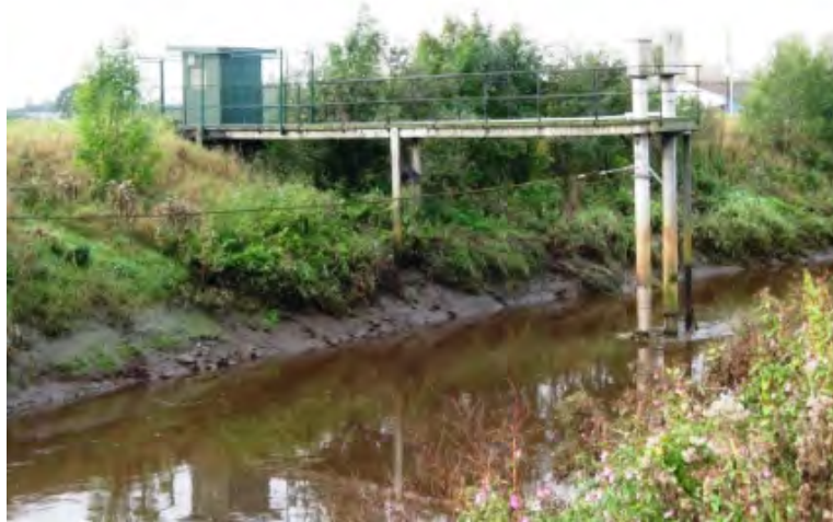
Figuur 32 - Tijmeetinstallatie te Kessel op de Grote Nete
