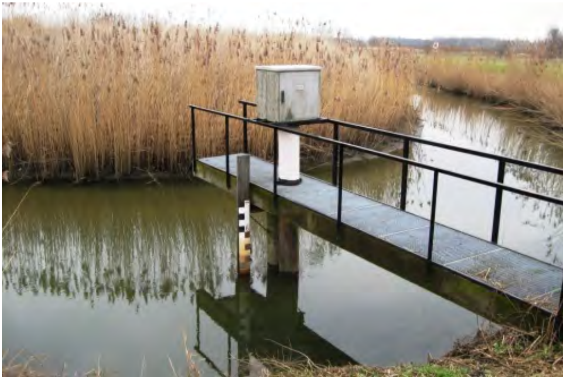
Figuur 42 - Tijmeetinstallatie te Zele op de Durme.
