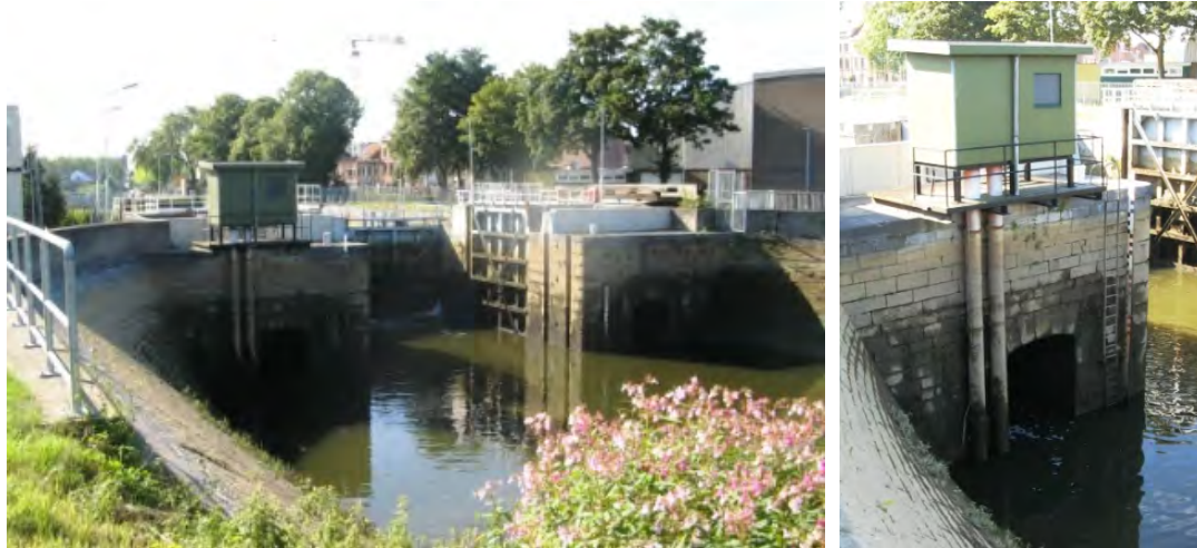
Figuur 33 - Tijmeetinstallatie te Mechelen Benedensluis op de Dijle
