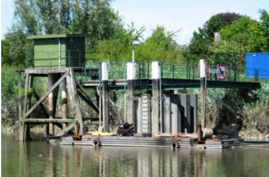
Figuur 39 - Tijmeetinstallatie te Tielrode op de Durme
