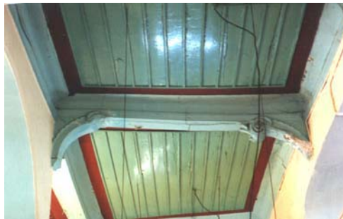
סדקים בקורות Cracks in beams
