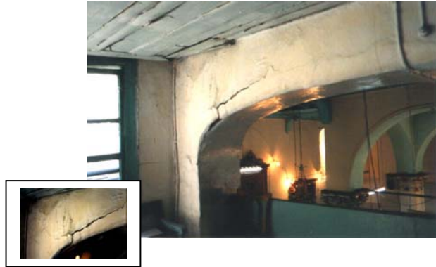
סדקים בקירות Cracks in the walls
