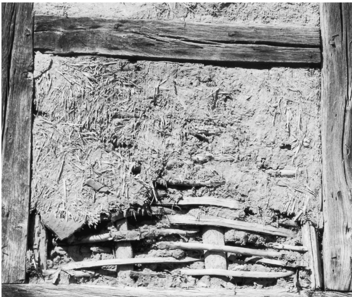
Schadhafes Gefach an der Außenwand eines Wirtschaftsgebäudes des Guts an der Kirche
