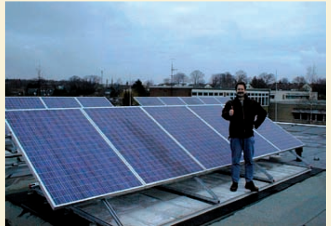
Der Kreis Rendsburg-Eckernförde baut schon seit Jahren auf den Einsatz von moderner Energietechnik – hier die Solaranlage auf dem Dach des Gymnasiums Altenholz
