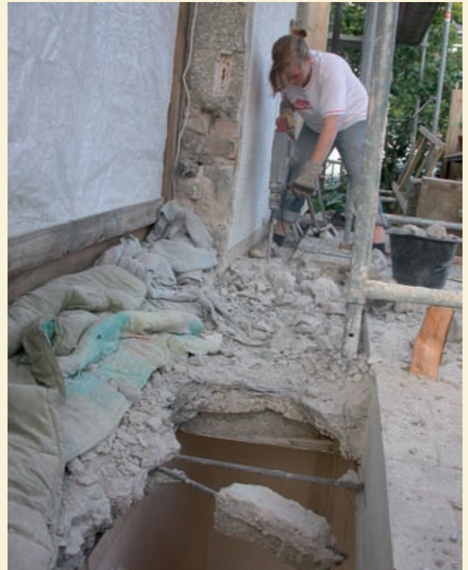
Wärmebrücken wie z.B. Stahlträger in Terrassen oder Balkonen sollten nach Möglichkeit im Zuge von Sanierungsmaßnahmen beseitigt werden.
