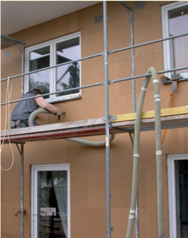
Einblasen von Zelluloseflocken – recycelte oder aus Naturmaterialien stammende Dämmmaterialien belasten die Umwelt weitaus weniger als auf Kunststoffen basierende.
