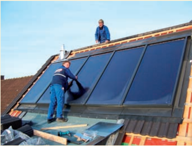
Zur Warmwasserbereitung und zur Bereitstellung von Heizwärme haben sich Solarkollektoren bewährt.
