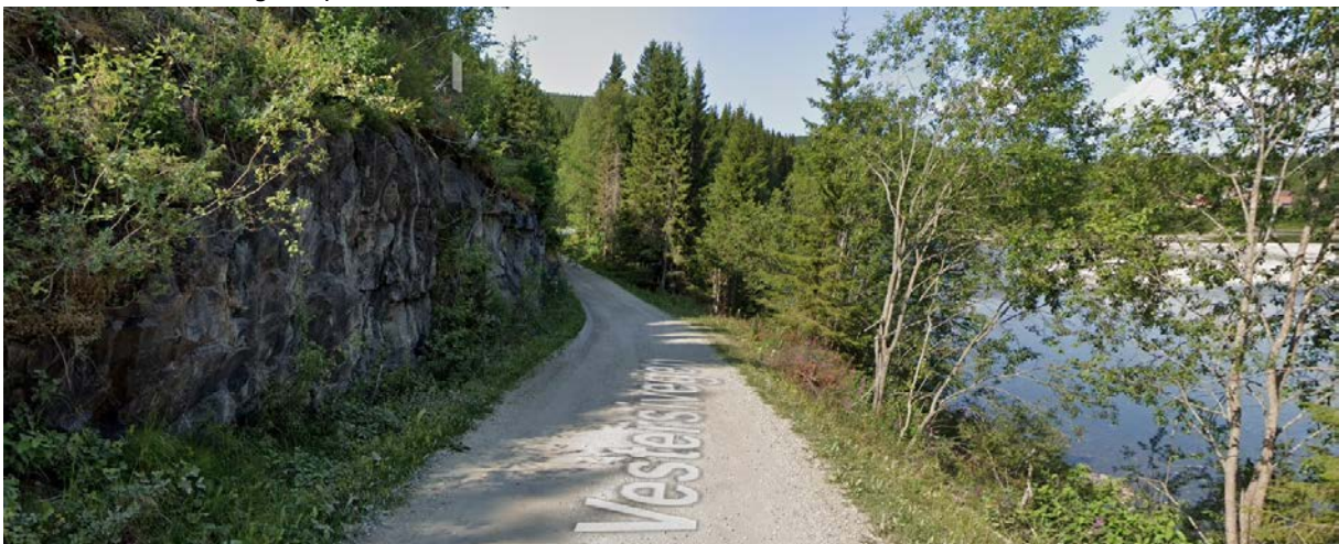
Forbi låsen går dagens smale grusveg over en bakketopp på ei «hylle» ut mot elva, og innunder ei nokså lurvete bergskjæring. Strekningen har ikke rekkverk (Googlemaps)
