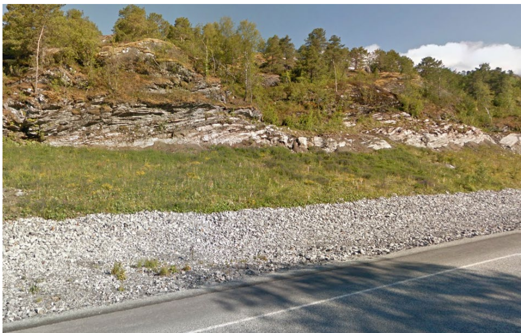
Feil utførelse rv. 80: Skråning opp mot berg besto av erosjonsømfintlige løsmasser. Hele skråningen er stabilisert. Øvre del kledd med tynt lag vegetasjonsdekke framstår med naturlig terrengtilpassning. At sprengtsteinshuden ikke er kledd nærmest vegen er visuelt uheldig, og skal ikke forekomme. (Foto SVV).
