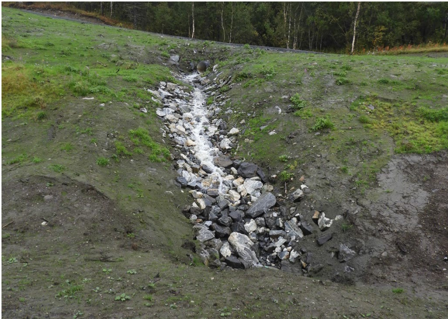
Eksempel på ikke vellykket energidemping med rauset stein i nedløp. Erosjonssikringen er ikke tilpasset retningsforandring i vannveien, har for lite høyde og for varierende høyde på sidene av løpet. Det er for stor variasjon i steinstørrelse, og vannet forsvinner fra overflaten før vannet på en kontrollert måte ledes inn i stikkrenna. Foto: E6 Helgeland
