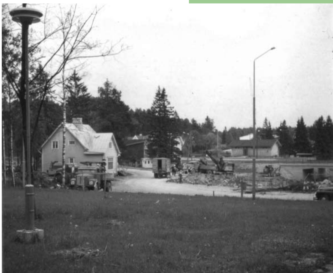
Liikenneympyräalueen rakennustyömaa. Vasemmalla Kauniaisten postitalo, jonka mukaan liikenneympyrän alue on saanut nimen Postitori.
