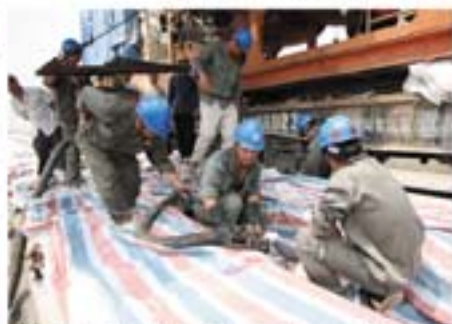
武广新广州站施工现场。成品CA砂浆性能优异，拌合及灌注操作简单、高效。
