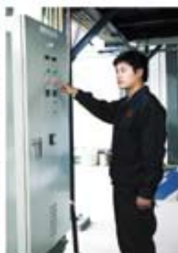
生产线所有电控、气动控制系统均集成在操作盘上。
